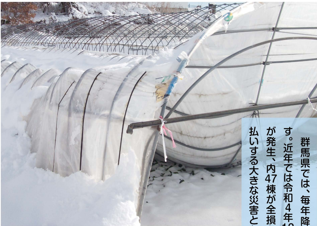
令和4年12月の降雪で倒壊したハウス
